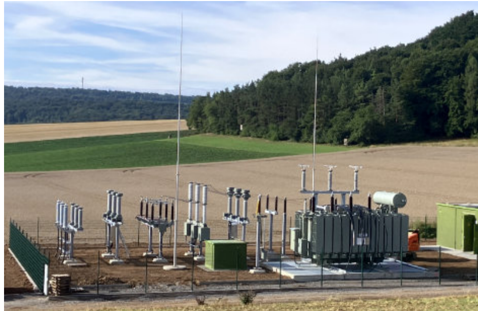
Unser Umspannwerk in Remlingen während des Baus
